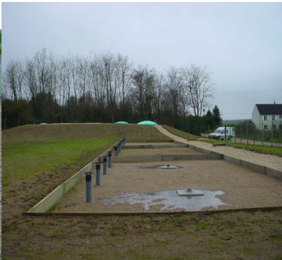
Filtres à sable
